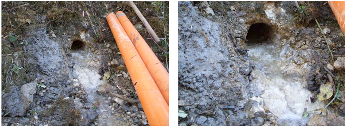
FOTO 7 – particolari del dreno in fase di spurgo
